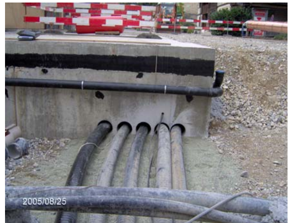
Fernleitungsabgänge ab Zentrale
